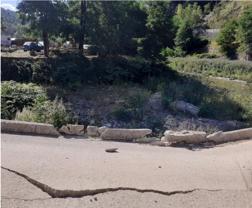
Pont endommagé par un épisode cévenol... non encore réparé trois ans après (Saint-Etienne Vallée Française, Cévennes)
